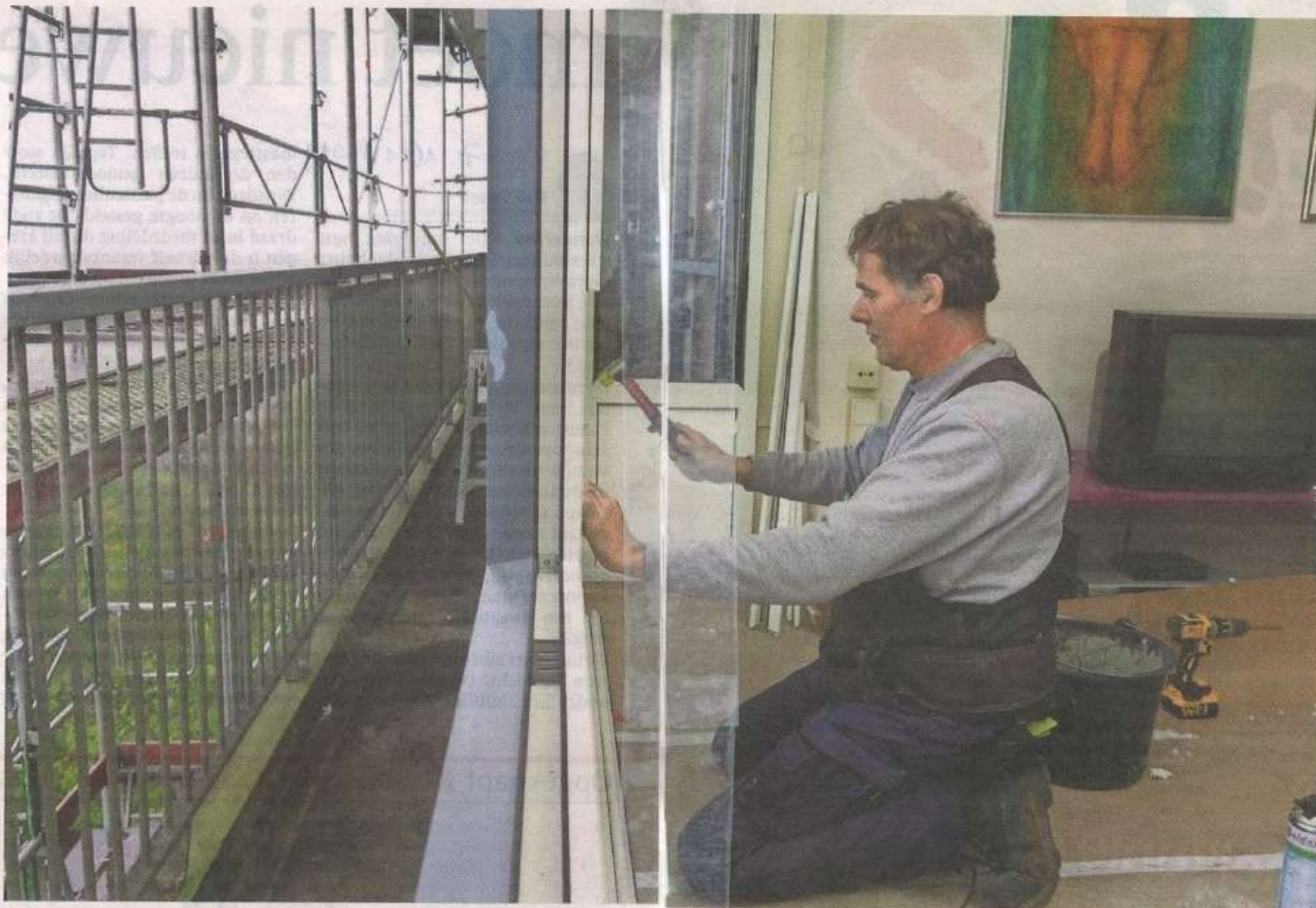
De renovatie van elke woning duurt dertien dagen. In een dag tijd gaat de
